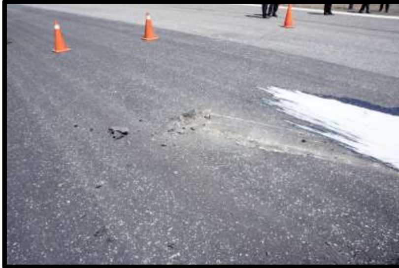
Fotografía No. 7. Punto de impacto del rotor principal con la superficie de la pista.
